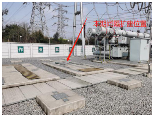
望龙 220kV 变电站现状
